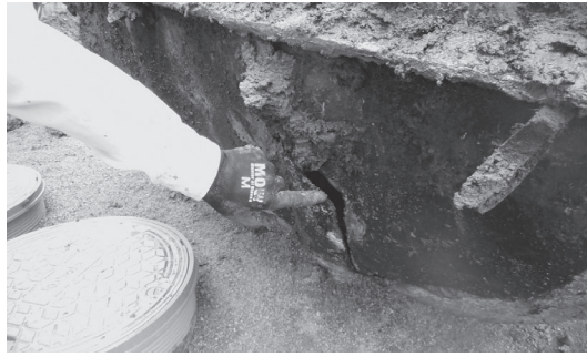
撤去した単独処理浄化槽から発見された穴
