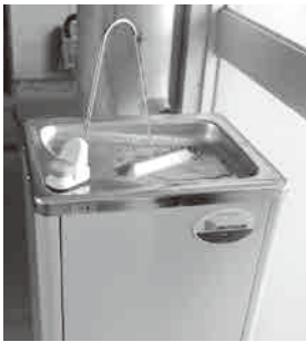
新しい冷水機(板倉中)
